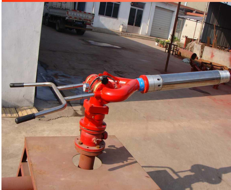
室外消防栓灭火系统
